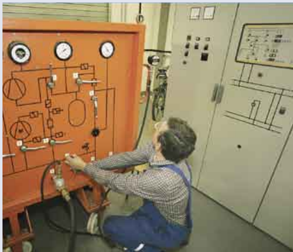
Gut ausgestattet und kompetent auch im Umgang mit gasisolierten Schaltanlagen: die Netzdienste Rhein-Main im Verbund Mainova
